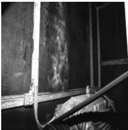
Foto 1: Vervuilde LBK: Oude installatie: glaswolbekleding kapot.
