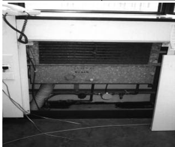
Foto 3: Vervuilde inductie-unit in werkruimte.
