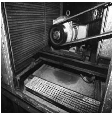
Foto 2: Vervuilde LBK: Oude installatie: overal vocht.
